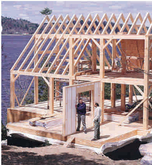
Figura 6 - 6: Se puede observar el conjunto de vigas horizontales e inclinadas y cómo transmiten los esfuerzos a los pilares o columnas.
