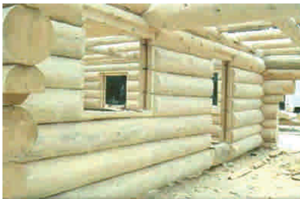
Figura 6-2: A. Vivienda construida con troncos macizos, de diámetro promedio de 30 a 35 cm.
